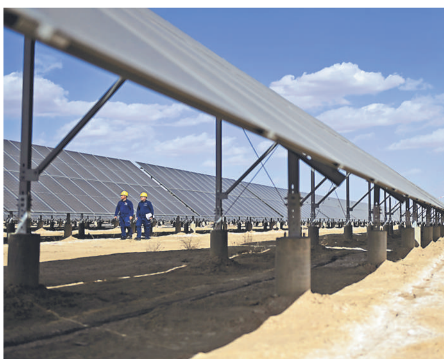
民勤红沙岗20万光伏项目的运行人员对现场进行巡检。
