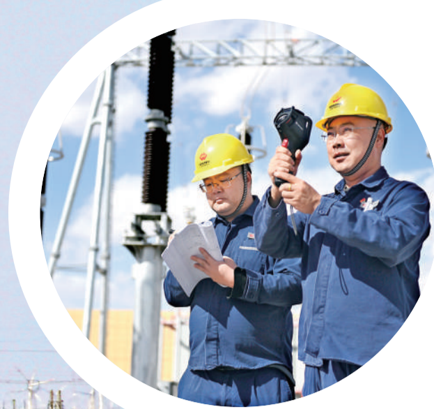
工作人员对升压站设备接点测温,确保安全运行。
