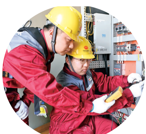
员工在风机塔底检查设备运行情况。
