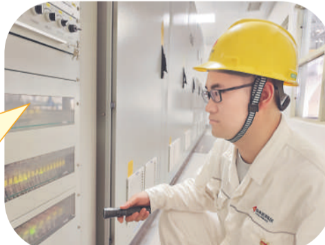
杨佩正在检查发电机励磁装置。
