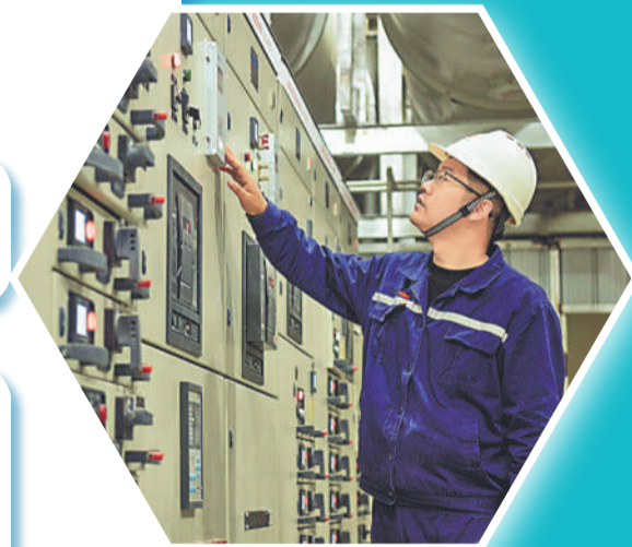
工作人员正在查看5号机组400伏厂用电装置运行情况。 甄学宝 摄
