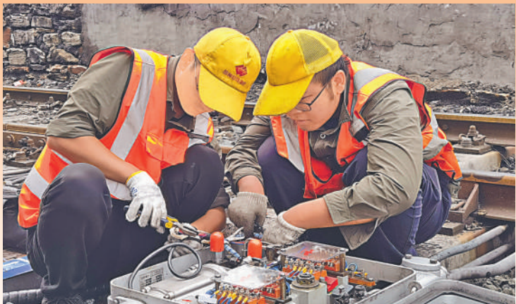
包神铁路巴图塔站区电务专业检修转辙机。通讯员 项 慧 摄
