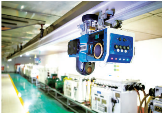
变电所矿用巷道智能巡检机器人。 通讯员 刘娜 摄
