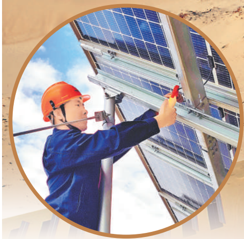
检修人员正在测量光伏组件输出电流。
