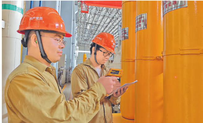
▲ 7月15日,广东多地高温炎热,电力需求连创新高。广东肇庆电厂全面落实迎峰度夏各项措施,全力保障能源稳定供应。图为设备检修人员测量油系统温度。
