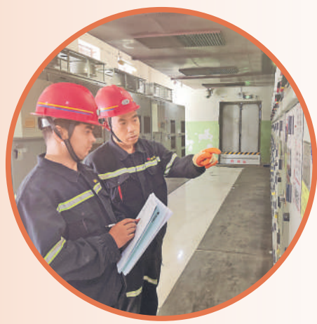
巡检工对各类开关运行数据进行记录复核。 通讯员 慕宾宾 摄
