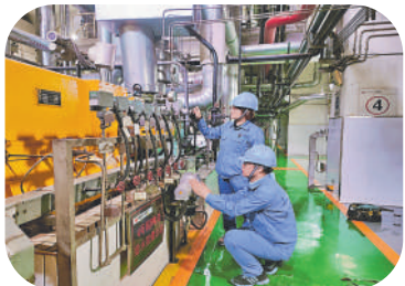
员工在回收水平台检查阀门内漏情况。 通讯员 金岳 摄
