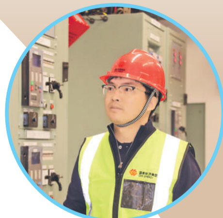
盛斌在巡视输电设备。
