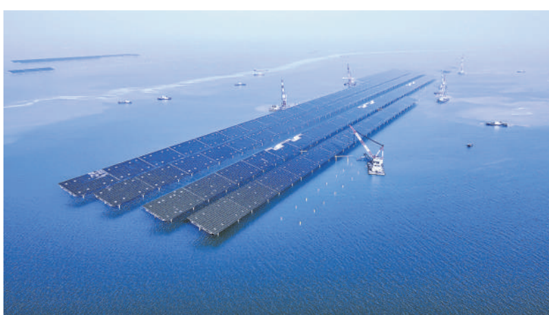
国华投资山东垦利100万千瓦海上光伏项目鸟瞰图。 通讯员 王加帅 摄
