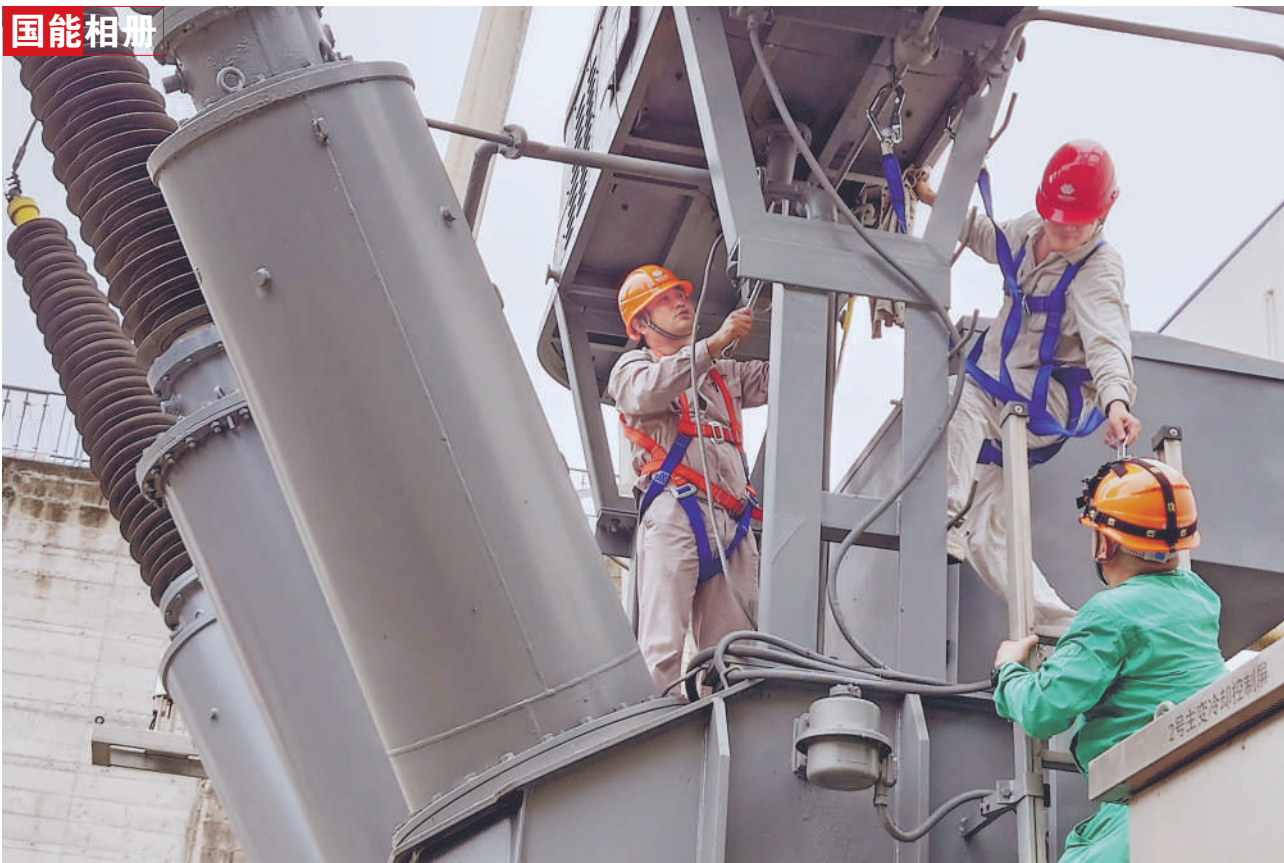
截至12月3日，四川毛滩公司年累计发电量4.33亿千瓦时，提前28天完成年度发电任务。该公司科学研判发电形势，精心谋划、周密部署，积极创造条件抢发电量，加大隐患排查力度，全面排查机组隐患，提升机组安全运行水平。图为维护人员正在进行主变停电消缺。
