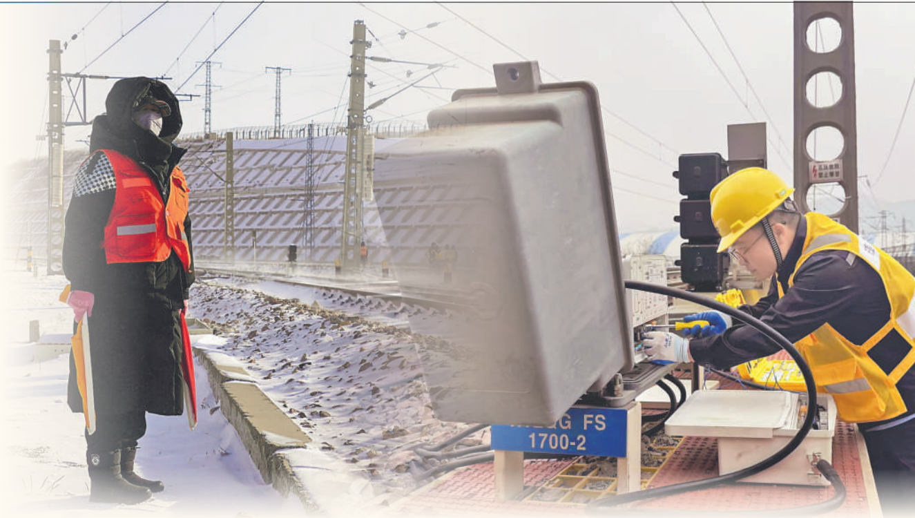
何天明正在检查区间ZPW-2000A自动闭塞设备。
