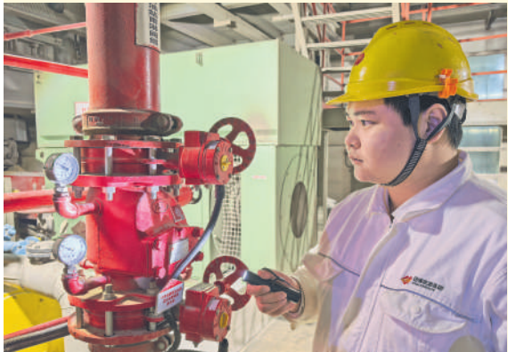
为确保冬季设备运行安全,江苏谏壁公司运行人员检查消防喷淋装置,确保迎峰度冬设备安全可靠。 通讯员 华建蓝 摄
