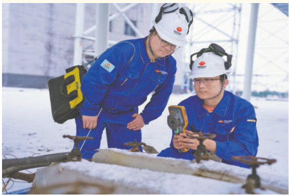
连日来,新疆乌鲁木齐迎来大幅降温降雪天气。新疆化工检修人员加大主蒸汽管道疏水系统等设备巡检力度,确保全厂供热、生产稳定。 通讯员 冯永强 摄
