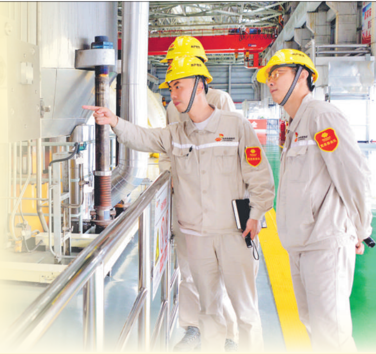
近期,重庆电厂多维度、多举措开启冬季能源保供模式,党员突击队深入一线对设备隐患特巡特检,保障设备平稳运行。 通讯员 王立新 摄
