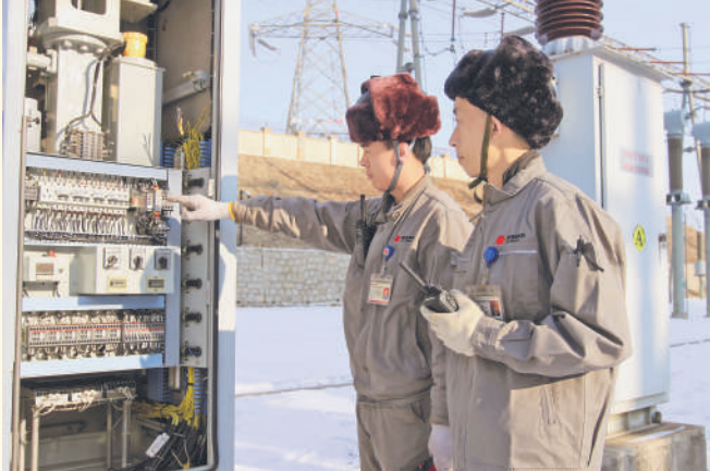
近期,吉林江南公司将迎峰度冬与能源保供紧密结合,加强重点区域设备温度、电流、振动、压力等参数监测力度,确保迎峰度冬期间机组设备安全稳定运行。 通讯员 孙国峰 摄
