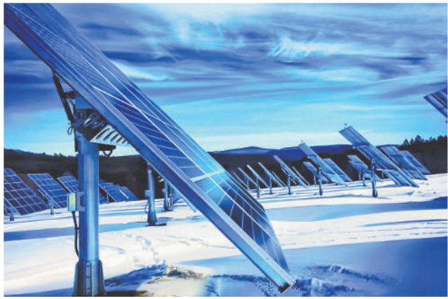
轻盈的雪花飘落在扎尼河露天矿光伏板上。 通讯员 李 飞 摄
