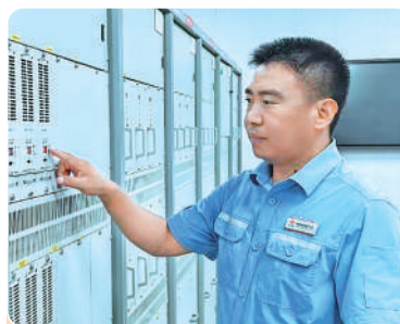
朱德华对机房设备进行巡视。
