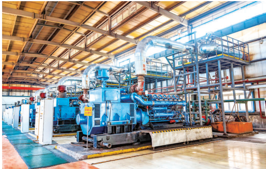
乌海能源一方面将瓦斯作为清洁能源转化为电能，另一方面投入瓦斯氧化蓄热项目为矿区供热，减排降碳，创造良好环保效益和经济效益。图为乌海能源天洁电力公司瓦斯电站发电机组。
