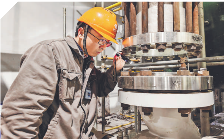
员工正在检查凝结水精处理系统管道。 特约记者 陆烨 摄
