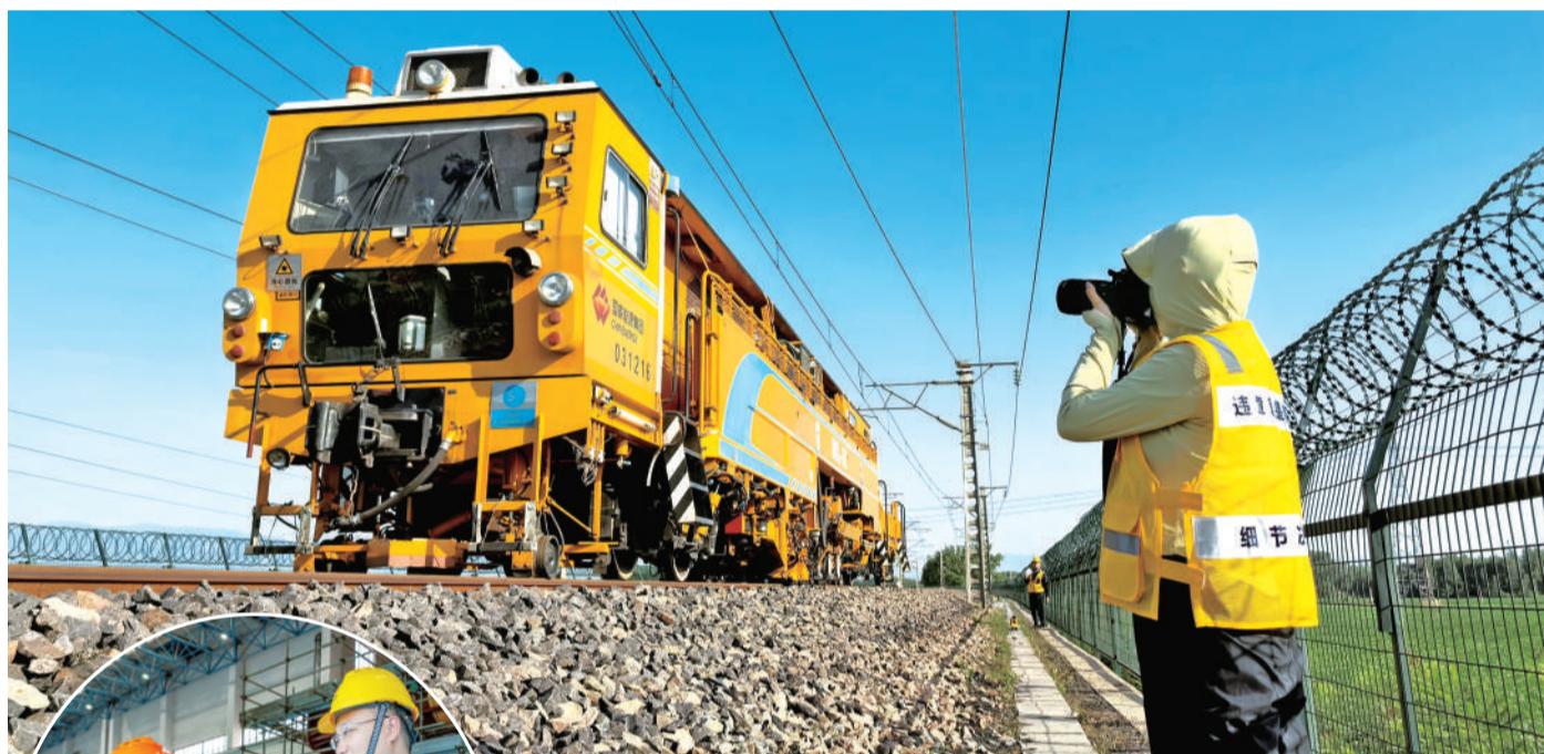
▲6月3日,朔黄铁路原平分公司组织新闻宣传人员深入铁路沿线采访,聚焦报道一线员工在能源保供中的感人故事。图为朔黄铁路原平分公司新闻宣传人员刘红霞正在拍摄大型捣固线路施工作业场景。 特约记者 任振华 摄
