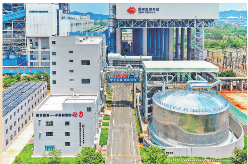
▲ 4月11日,全国首套600兆瓦火电抽气熔盐储能项目在河北公司龙山电厂正式投运,为构建“清洁低碳、安全高效”的现代能源体系提供有力支撑。通讯员 王建涛 摄
