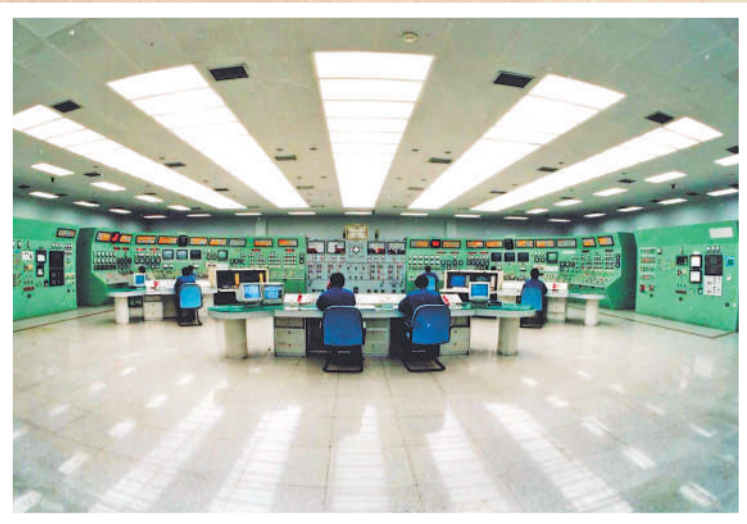
山东石横公司一期机组集控室。
