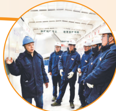
技术人员正在进行风电机组箱变讲解。
