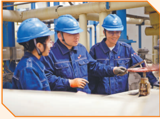
宁夏煤业煤制油空分厂党总支党员操作工艺凝液外送岗。高珊摄
