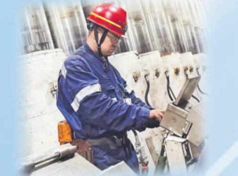
检修班班长李平正在检查支架电控运行情况。
