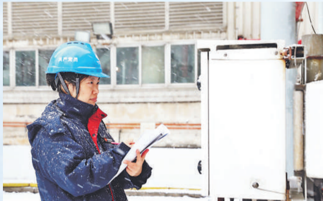
▲ 1月19日，郑州市气象台发布暴雪蓝色预警，最大积雪深度预计10-13厘米。河南濮阳公司第一时间启动极端天气应急保供预案，成立保供工作小组，确保思想、责任、措施、物资“四到位”。图为电气检修人员正在抄录变压器在线监测数据。 通讯员 董越 摄
