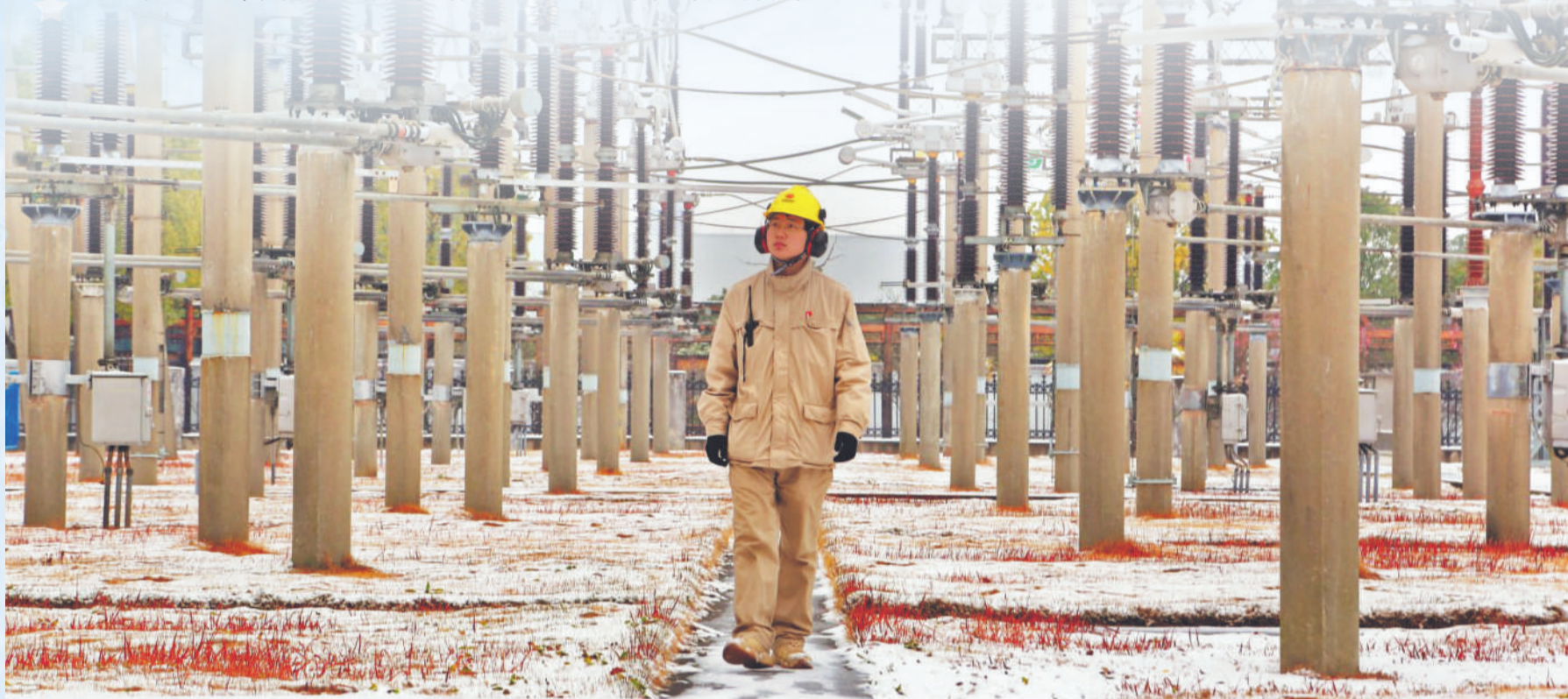
▲ 1月20日，寒潮裹挟着风雪席卷安徽。面对风雪挑战，安徽公司池州电厂闻雪而动、逆寒而行，在冰天雪地里织起温暖可靠的保供网。在该厂220千伏升压站，巡检员细致排查低温下的设备状态，确保第一时间发现并消除冰冻隐患，筑牢保供根基。 通讯员 李月 摄
