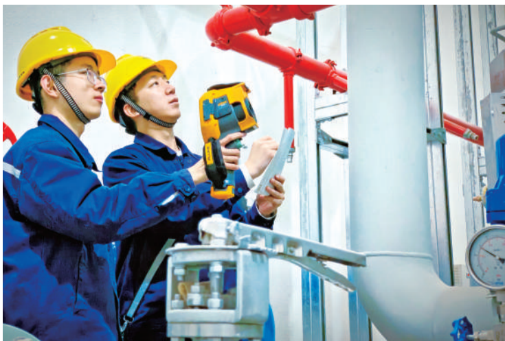
青海玛尔挡分公司运维六值成员在对主变进行测温。
