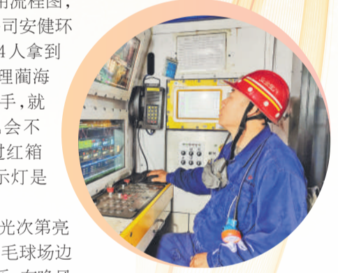
职工正在智能化综采工作面集控室认真观察工作面设备运行情况。
