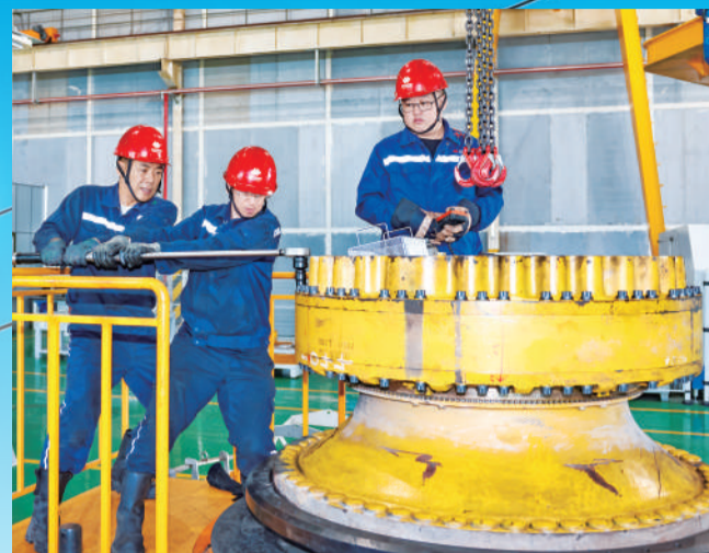
▲ 为扎实推进“事故警示月”活动走深走实,准能集团设备维修中心聚焦矿用卡车安全隐患,专项开展结构件与附属件开焊、开裂隐患排查整治工作。图为该中心钳工正在核验矿用卡车前仰角螺栓力矩。 关松 摄
