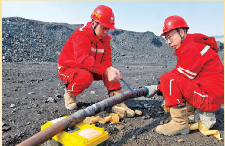
▲ 3月份以来,准能集团黑岱沟露天煤矿灵活利用设备走铲、计划检修等时段,统筹开展供电线路维护工作。 向南 摄
