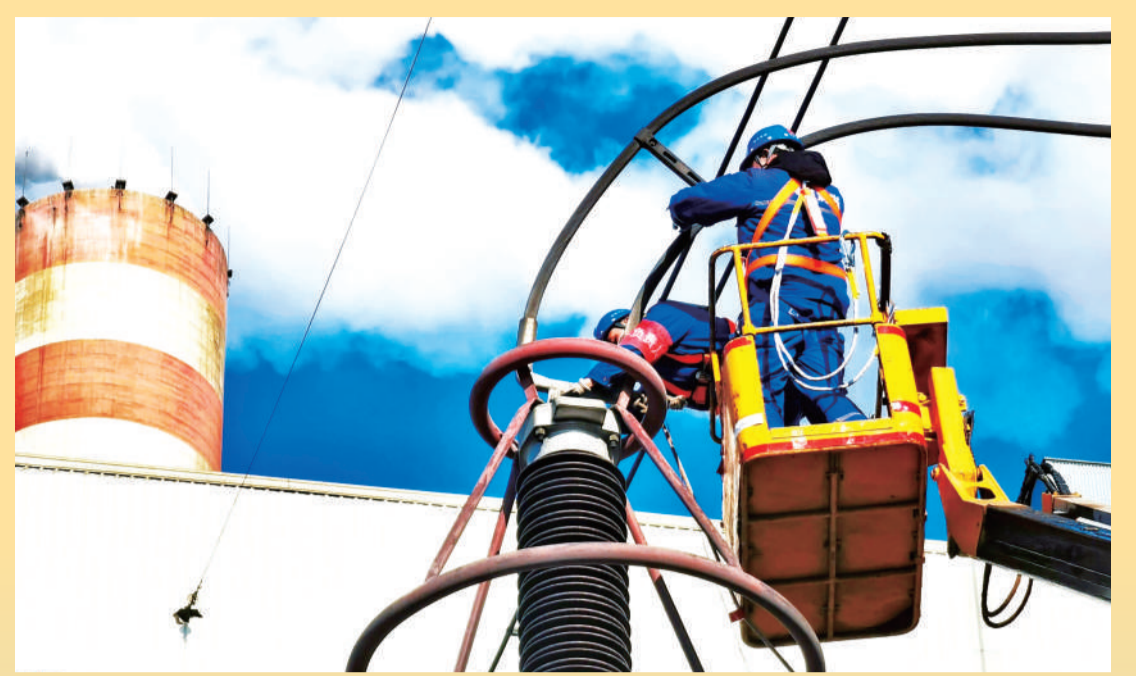
▲ 3月23日,国电电力绥中公司工作人员正在对主变高压套管高压引线进行细致检查。 韩兴华 摄
