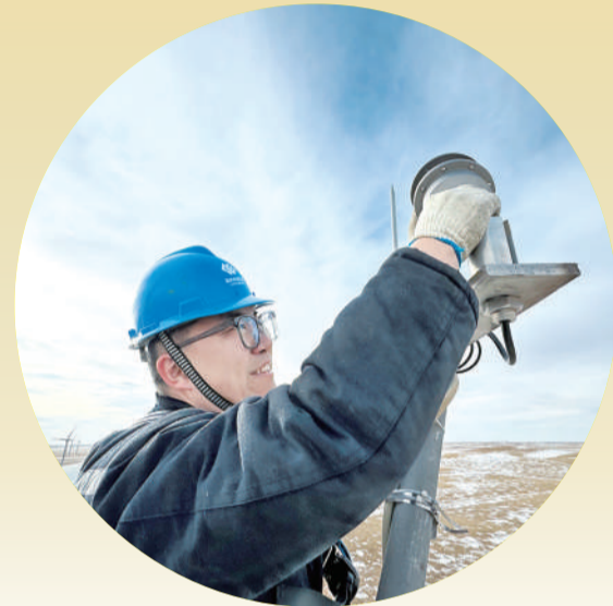
▲ 3月24日,国电电力内蒙古新能源娜仁风电场开展风机设备安全大检查。 刘一航 摄
