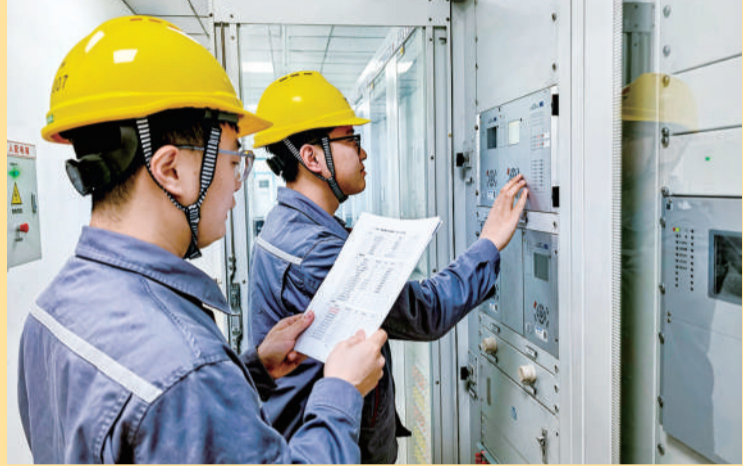
▲ 3月10日,国华投资山东分公司利津风电场员工正在核对继电保护装置定值。 曹善旭 摄
