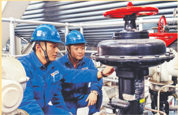
▲ 3月28日,湖南岳阳公司抢抓春季设备运维关键期,巡检员检查气动调节阀密封情况。 梁经纬 摄
