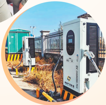
▲ 随州电厂新增电动汽车充电桩。
