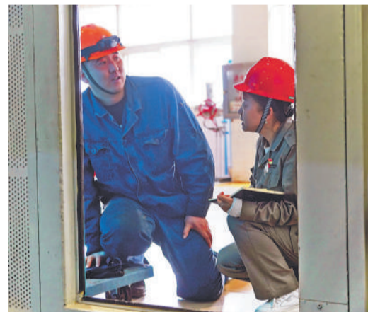
▲ 4月16日，吉林双辽公司3号机组C级检修进入第十天，各个检修点位上一派热火朝天、秩序井然的奋战景象。该公司宣传主管邓凤影（右一）在现场了解检修进展情况。通讯员 张欣 摄
