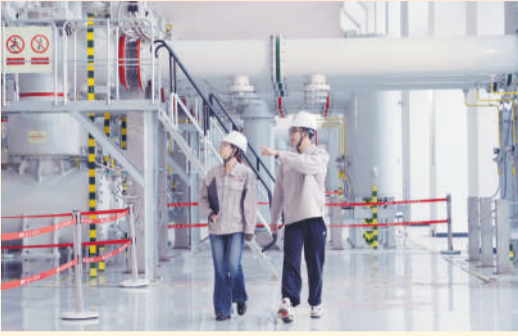
职工正在GIS室巡检。
