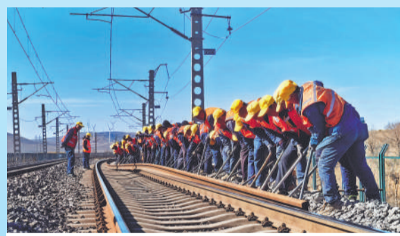
新朔铁路大准线2026年春季集中修更换长轨条作业。赵晓东摄
