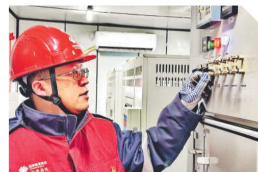
刘明昊在变电站设备间对二次保护装置进行开关操作与状态核查。
