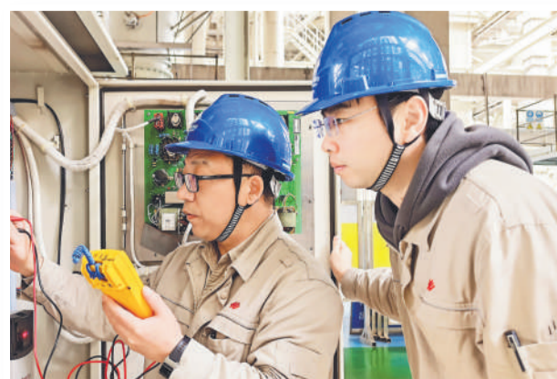
合肥公司炉控班正在优化给煤机控制系统。
