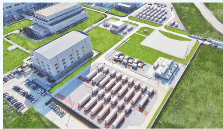
国内首个集成“磷酸铁锂+钠离子+全钒液流+飞轮”四维储能技术的复合型智慧储能示范项目——山东蓬莱电厂四维复合智慧储能项目。 翟飞飞 摄
