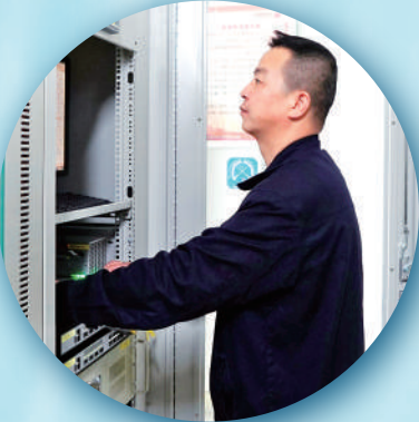
国电电力宁夏新能源现场运维人员在查看电子间设备。
