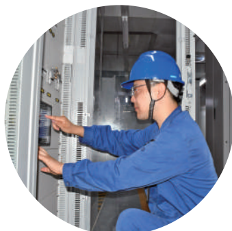
何智在电气控制室进行日常设备巡检。
