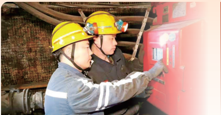
变压器高压开关运行状态。 工作人员在查看移动
