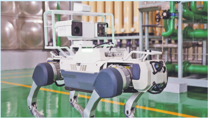
安吉电厂机器狗正在开展巡检工作。
